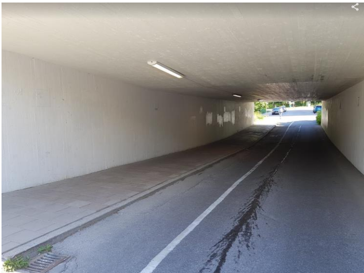
Bilaga 1. Figur 4. Gångtunnel som har stor betydelse för skyfallssituationen av fastigheterna Balladen 1–5. Det syns på bilden att gångtunneln har en markant höjdsättning som inte eller delvis inte finns med i modellen i detalj.
