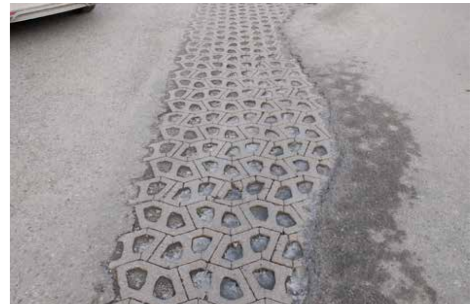
Betongsten sannolikt från byggtiden framträder där asfalten spruckit sönder i sydöstra delen av fastigheten.
