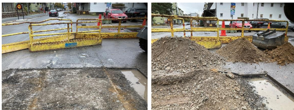
Figur 13. Undersökning av försvarets gamla järnvägsspår längs Fridenborgsvägen. (Vänster) Spåren framträdde i rostig karaktär strax under asfaltslagret. (Höger) Jordhögar från provgröp. Från vänster jord mellan 0-0,2 m, nästa hög 0,2-0,7 m och sista rostbruna hög mellan 0,7-1 m. (2022-10-24)
