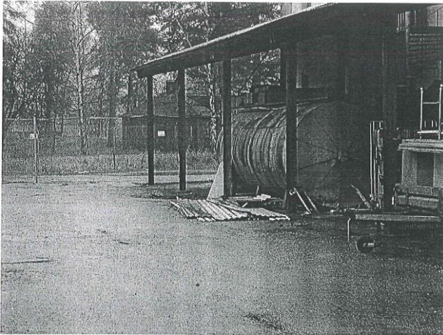
Figur 3. Mobil panncentral med cistern vid östra gaveln av försvarets gamla förråd, utsikt sydväst där det idag står Mulle Meck-parken. Förrådet kallas "befintlig byggnad 1" i Bilaga B. Foto hämtad från Bilaga 4 från VBB VIAK:s rapport (VBB VIAK, 2000).
