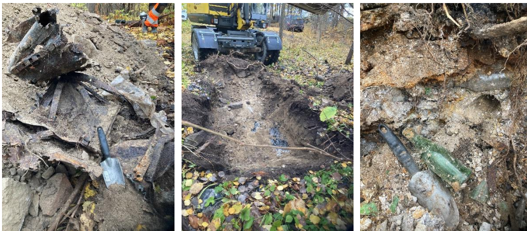
Figur 16. Bilder från tippområde 1, bakom bilverkstaden. (Vänster) Provgrop 22VM20. Metallskrot i form av eventuellt gammalt arkivskåp vid 0,5 m djup. (Mitten) Provgrop 22VM21. Asfaltslager vid 0,6 m djup. (Höger) Provgrop 22VM22. Jordprofil mellan markyta och ca 0,5 m ner. Fyll med glasflaskor och rost från diverse metallskrot. (2022-10-24)
