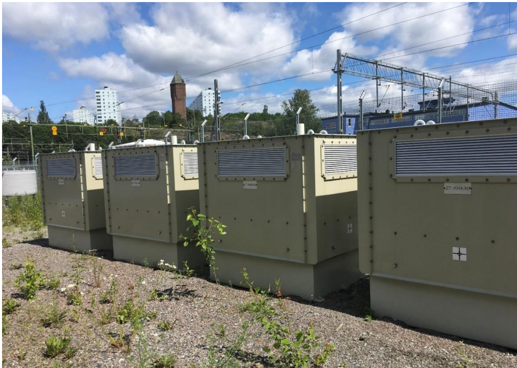
Bild 1: Sugtransformatorer vid Kc SO
