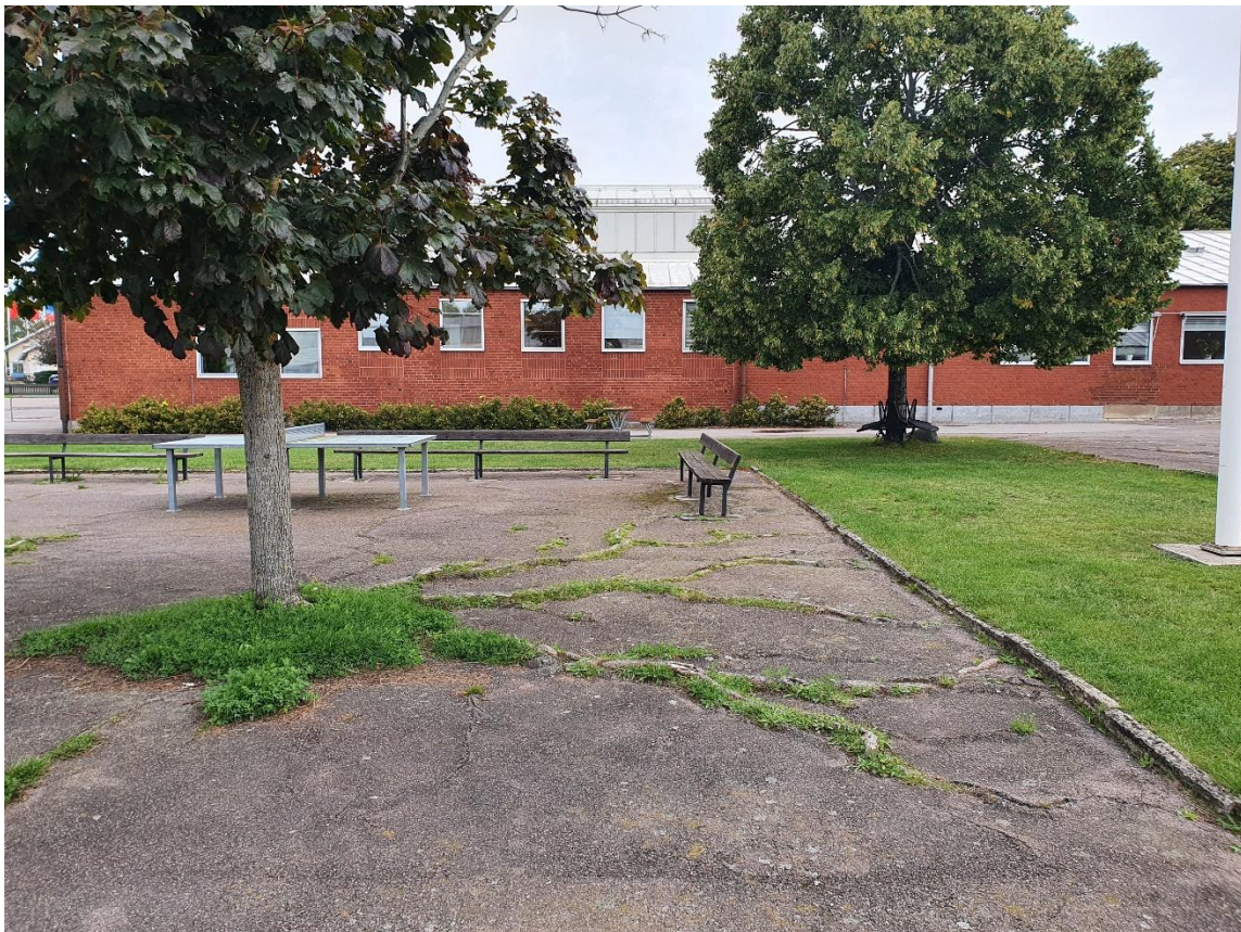
Figur 9. Träd med kraftig rotuppträngning i asfalt. Arkivbild.
