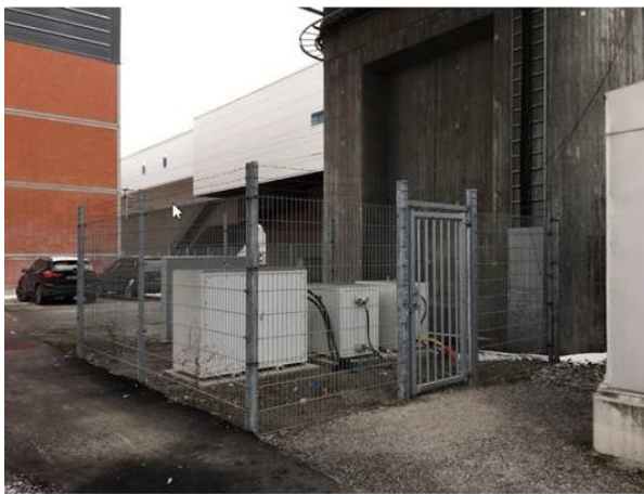
Figur 28. Elskåp placerade under gångbro nordväst om Tygeln 3.
