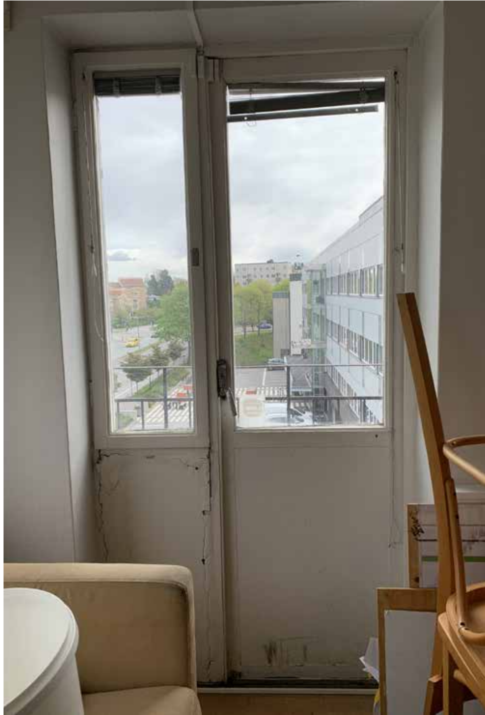
Före detta direktörsrum, plan 4, sprucken balkongdörr i trä.
