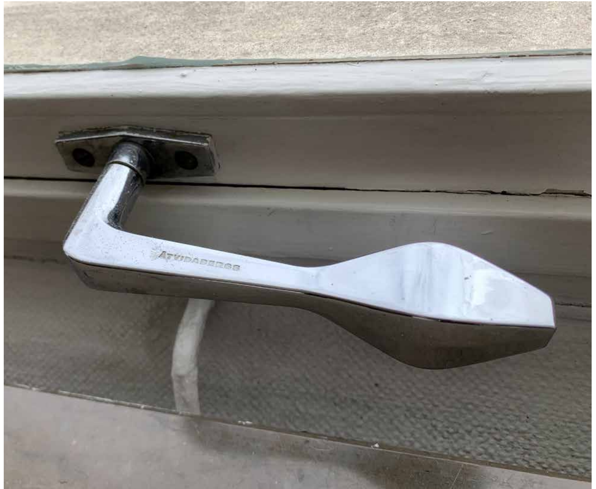
Modernistiskt gestaltat fönstervred från Åtvidabergs, plan 4. I nederkant skimtar ursprunglig fönsterbräda i kalksten.
