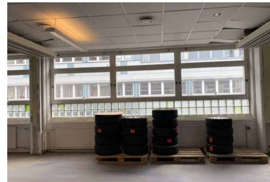
Fönsterparti mot väster i plan 2. Glasbetong kan missfärgas med åren, med färgskiftningar i grön, blått eller gult. Sentida undertak.
