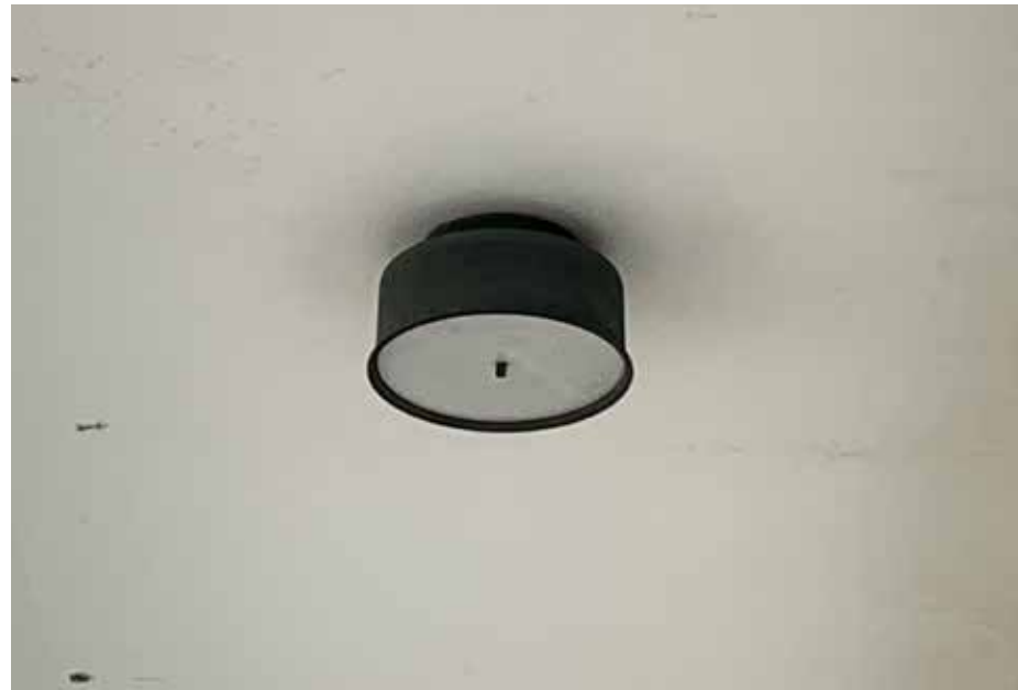
Ursprunglig belysningsarmatur i skärmtaket ovan sidoentrén mot väster.
