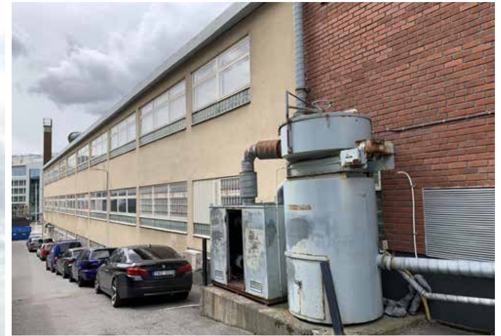
Längsidan mot öster med ett äldre fläktaggregat i förgrunden.
