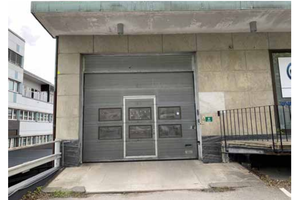
Infartsporten mot Ekensbergsgatan är utbytt. Fasad klädd i marmor och skiffer.
