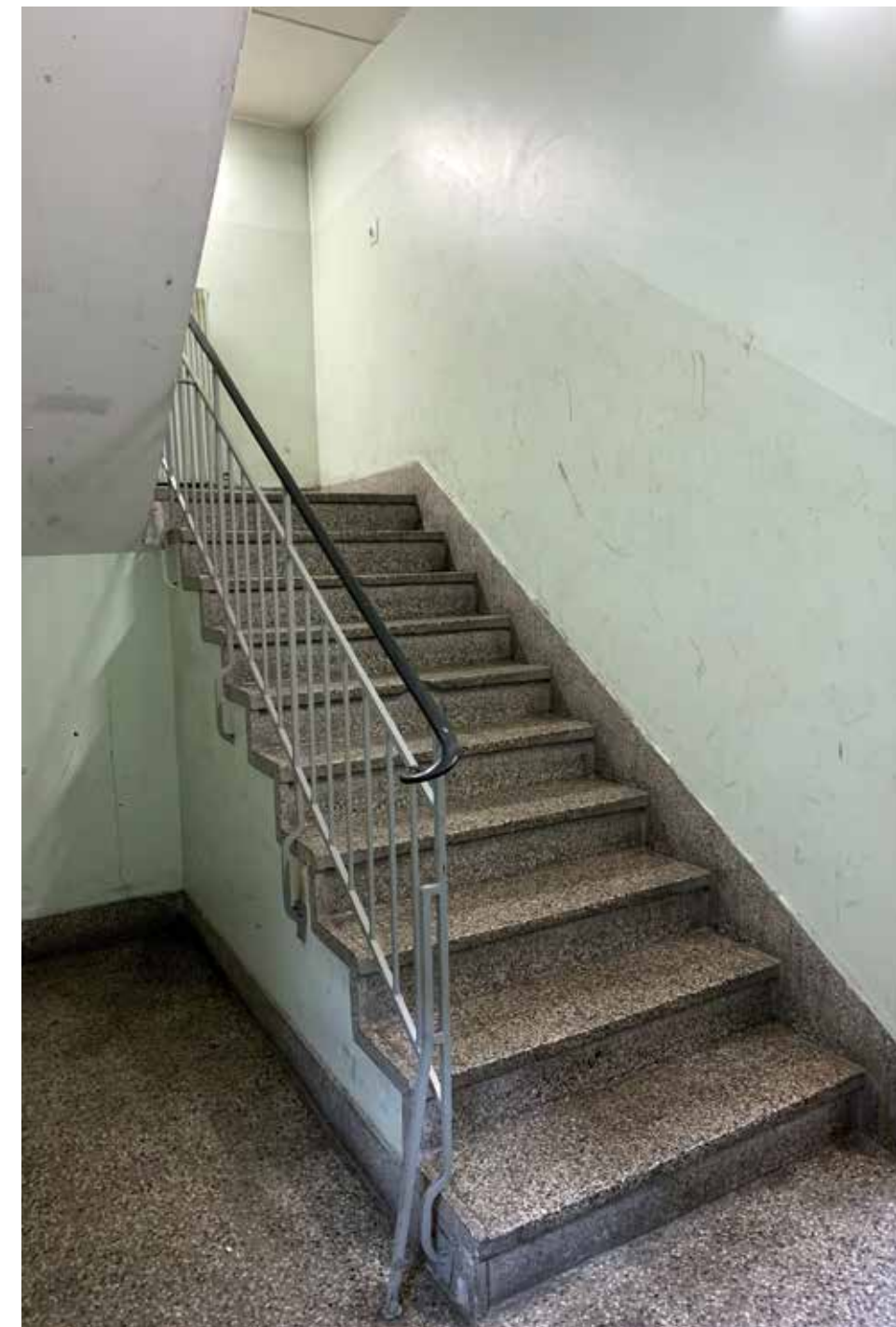
Norra trapphuset i plan 0. Golv och steg i cementmosaik, smidesräcke med plastöverdragen handledare.
