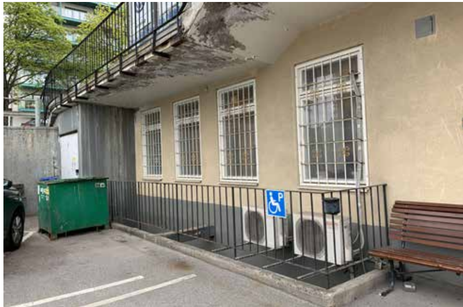
Högdagens nedre del ligger i suterräng. Bilden visar att gångbron till sidoentrén har kraftiga skador med blottad armering i betongen.
