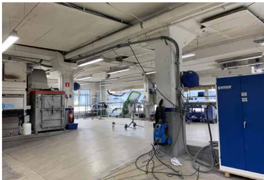
Lackeringsverkstad i södra delen av plan 1.
