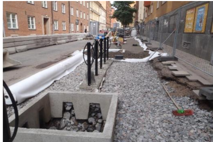
Figur 23: Exempel på etablering av skelettjord i befintlig miljö i Stockholm. Foto: Björn Embén, Trafikkontoret Stockholms Stad. Källa: WRS AB, 2017 rev. 2019.
