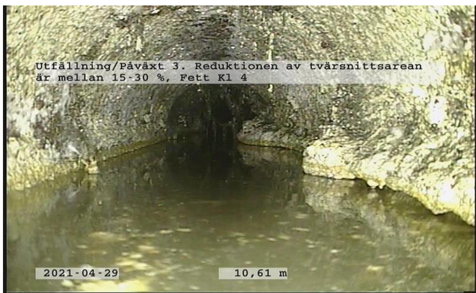
Bild 1. Fett i en spillvattenledning i Solna år 2021
