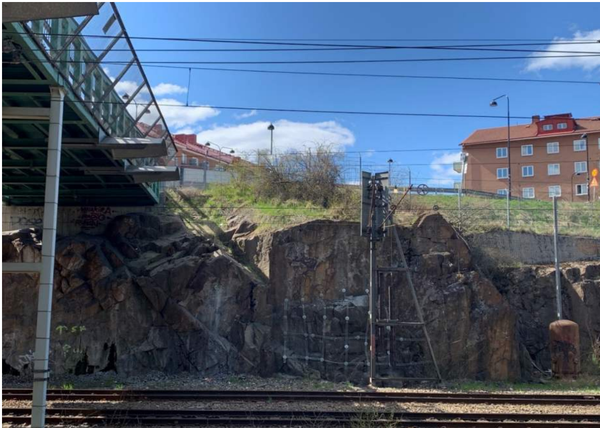
Figur 3 – Bergslänt med förstärkning
