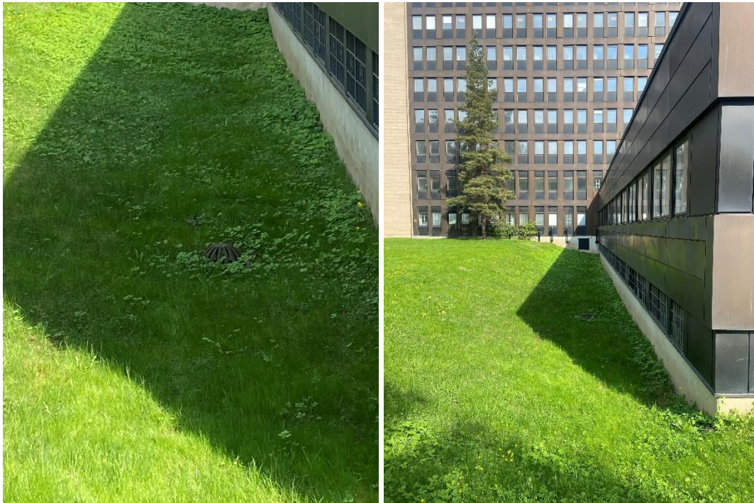
Figur 27. Större lågpunkt in mot fasad med kupolbrunn i botten.
