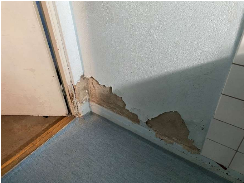
Figur 4-2 – Fuktskada i källaren, 2
