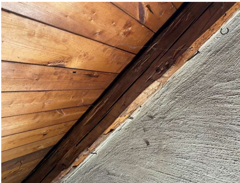
Figur 4-5 – Skador i träbalkar, 2
