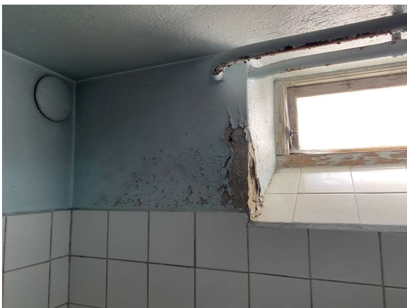
Figur 4-3 – Fuktskada i källaren, vägg och fönsterkarm
