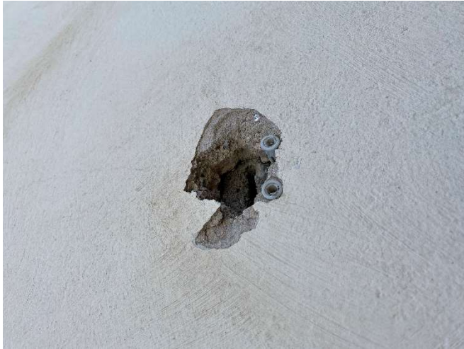
Figur 3-3 – Skada i fasad som redovisar puts på betongstenblock
