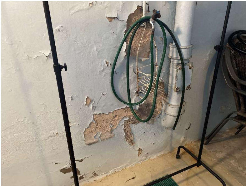
Figur 4-1 – Fuktskada i källaren, 1
