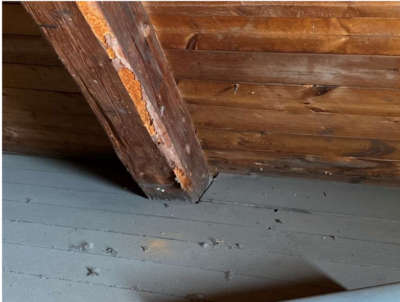
Figur 4-4 – Skador i träbalkar, 1
