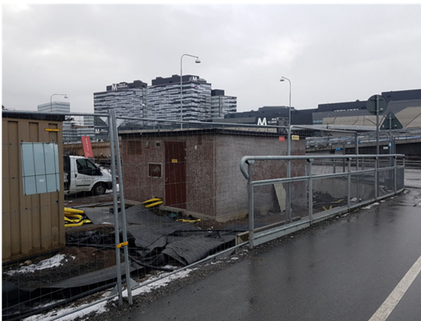
Figur 5: I lågpunkten på Signalen 3 finns idag en transformatorstation.
